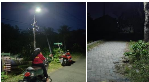
Gambar 3. Lampu Penerangan Jalan Umum yang telah Beroperasi.
